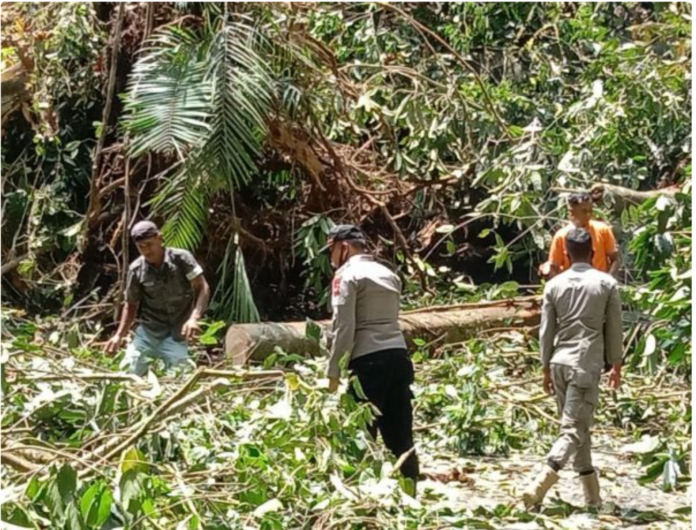
Kondisi badan jalan membuat sulit untuk di terobos, Jum'at (19/03).
